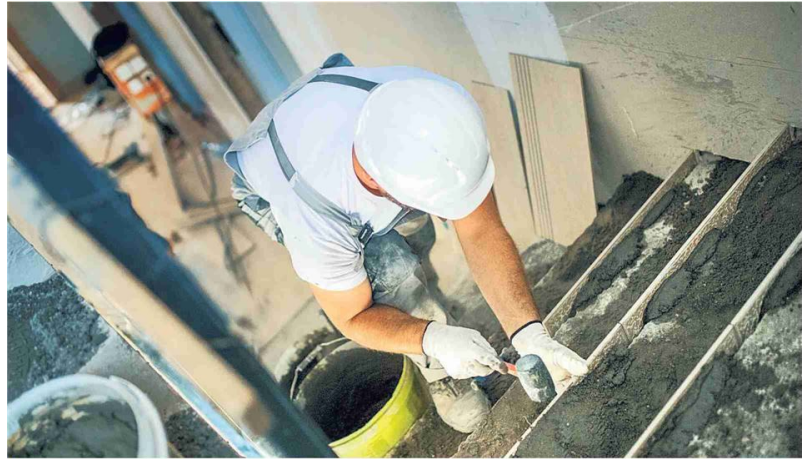
▲ Un cantiere Per l'associazione dei Geometri l'80% delle compravendite è rallentato dalle piccole difformità
