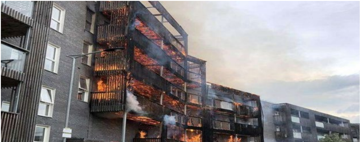
DIFFUSIONE DELL'INCENDIO TRAMITE BALCONI ESTERNI
